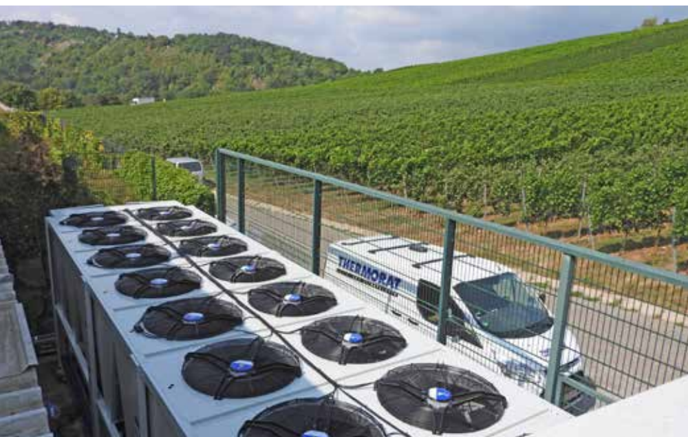
Zentrale Kälteversorgung in Außenaufstellung
